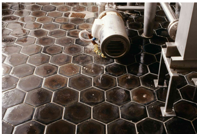
Šestihhranná dlažba v pivovaru (6HR/30R)
