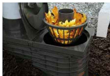
3. Vyprázdněte koš se splaveninami
